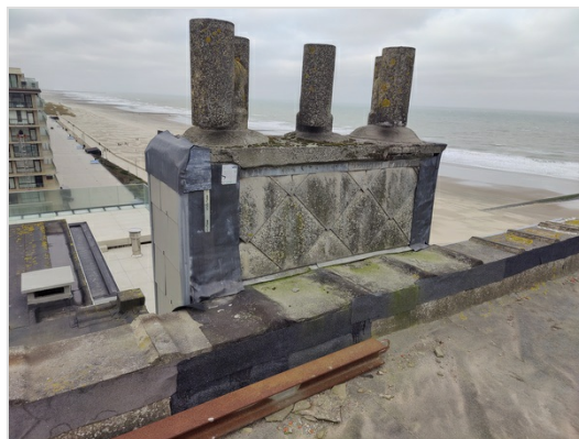
Opzetstuk schouw te vervangen
