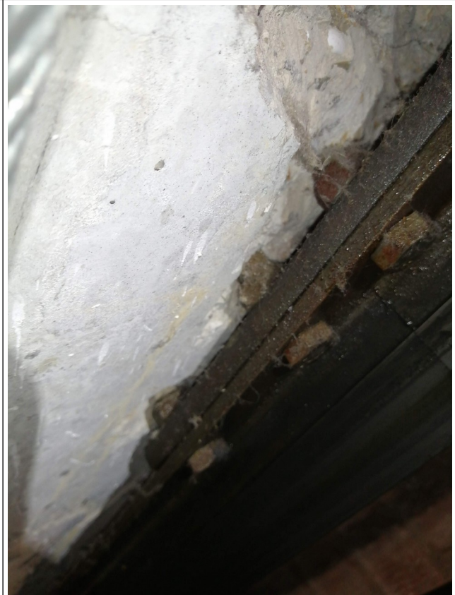
Bouten waarmee twee stukken geleider aan mekaar zitten, werden zelfs in de beton uitgekapt.
