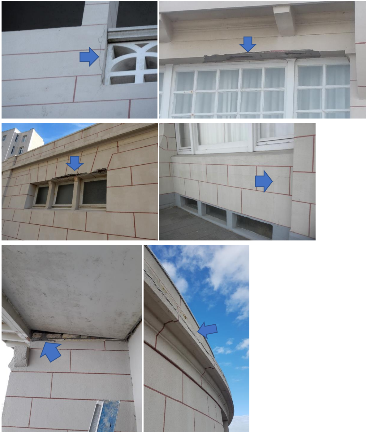
Figuur 104: Foto's van barsten, betonaantasting en loszittende houten luifel kant Zeedijk (Erfgoedstudio)
