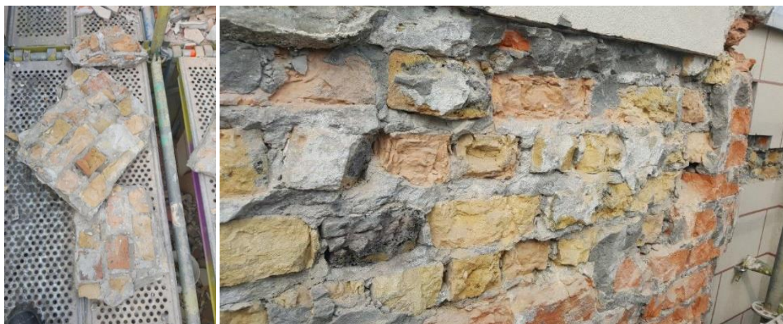
Figuur 43: Schadebeeld aan het metselwerk – grote stukken metselwerk met pleister aan komen los van de gevel (arch. Joost Beke)
