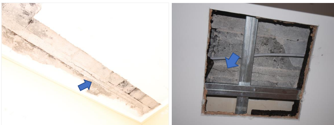
Figuur 75: Voorbeelden van plafonds met lichte beschadiging (Erfgoedstudio)
