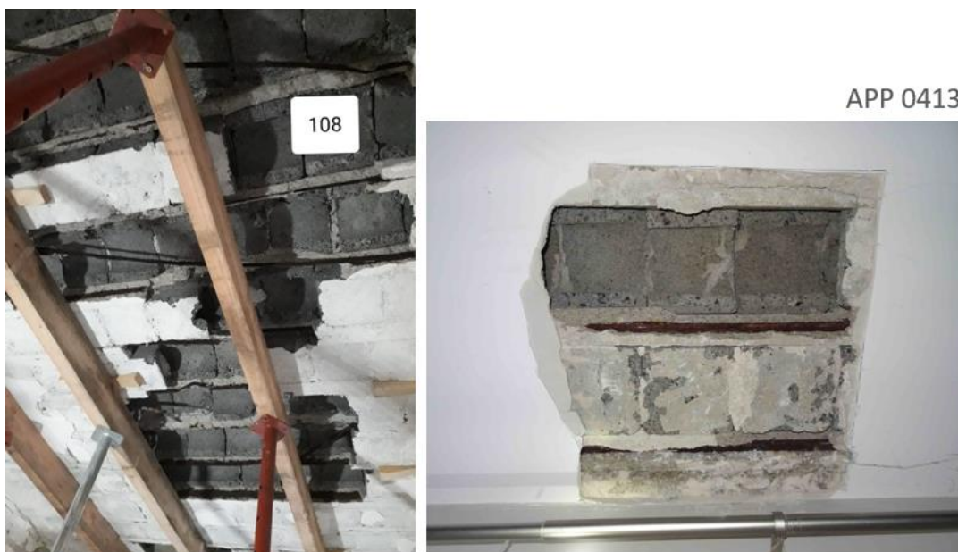
Figuur 78: Voorbeelden van plafonds met grote beschadiging (Erfgoedstudio)
