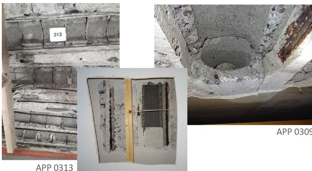
Figuur 113: Foto's van de aangetaste gewelfstructuren op de 3 de verdieping (LMS Architecten)
