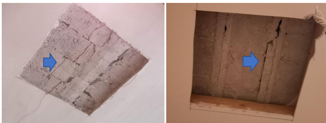
Figuur 76: Voorbeelden van plafonds met matige beschadiging (Erfgoedstudio)
