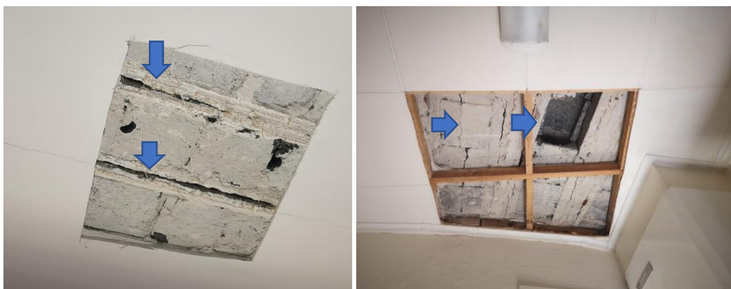
Figuur 77: Voorbeelden van plafonds met aanzienlijke beschadiging (Erfgoedstudio)
