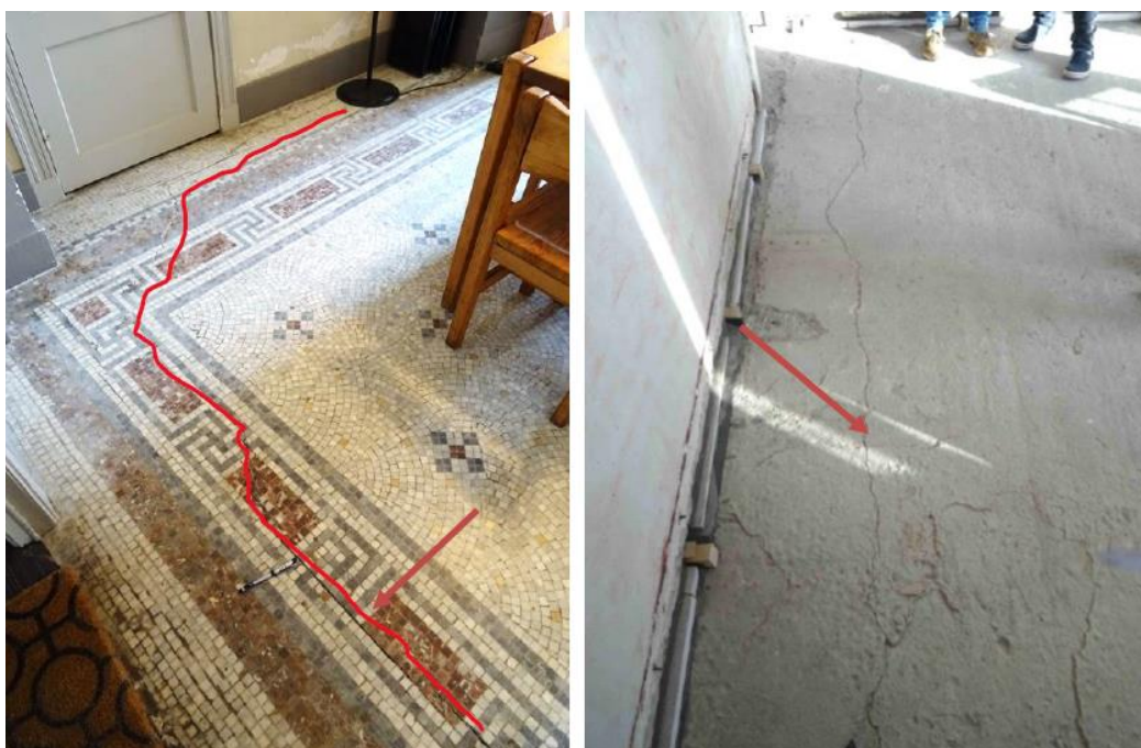
Figuur 115: Foto's van scheurpatronen in muren (LMS Architecten)
