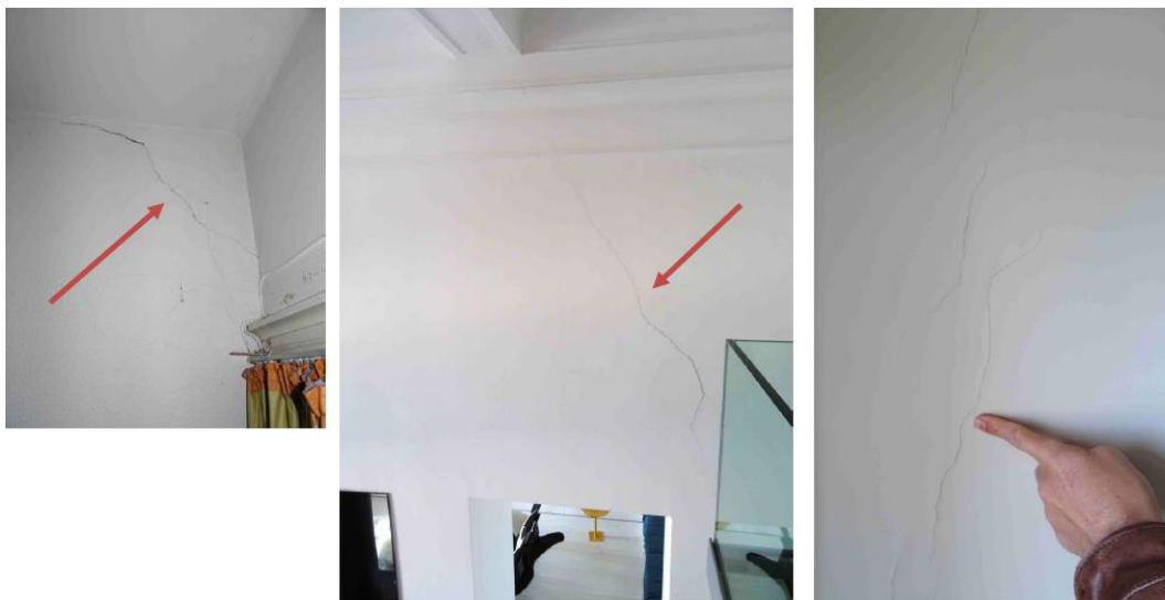
Figuur 114: Foto's van scheurpatronen in muren (LMS Architecten)
