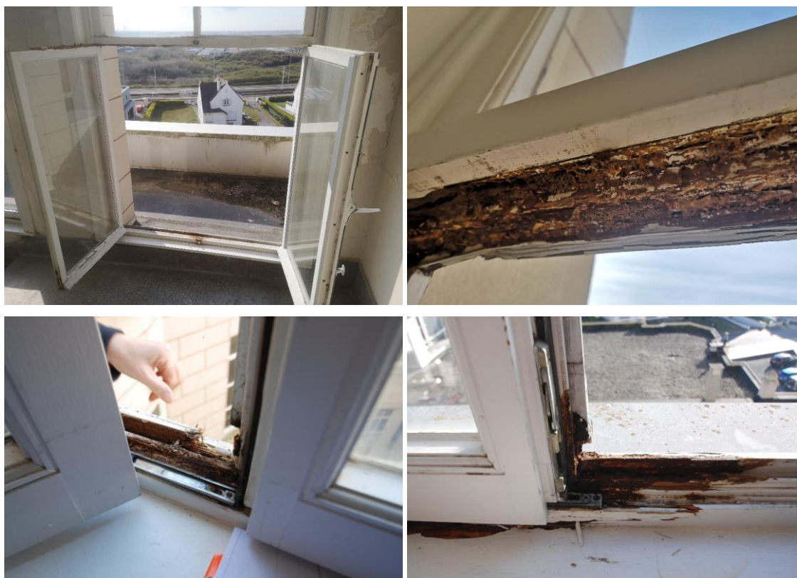
Figuur 103: Voorbeelden van aangetast buitenschrijnwerk in de algemene gangzones op de verdiepingen (Erfgoedstudio)
