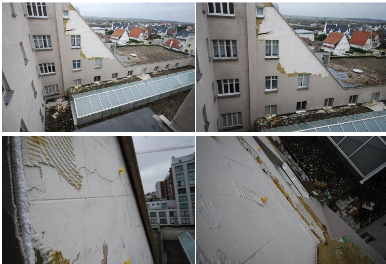
Figuur 46: Foto's van de stormschade en de afgerukte panelen aan de binnenzijde van de oostelijke straatvleugel (Erfgoedstudio)
