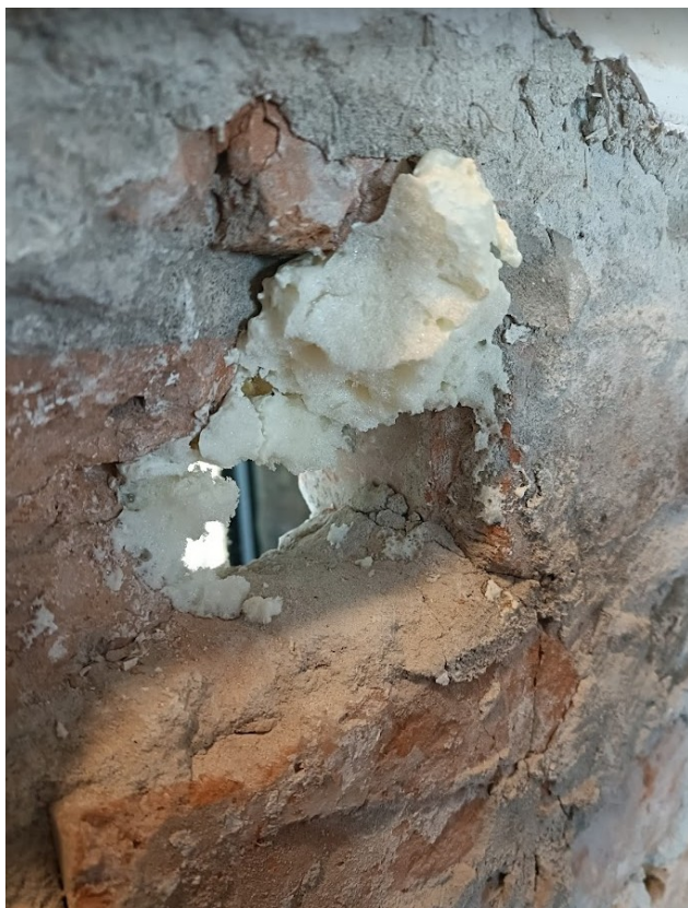
Het metselwerk en de metselspecie desintegreert al door er met een schroevendraaier in te prikken.
