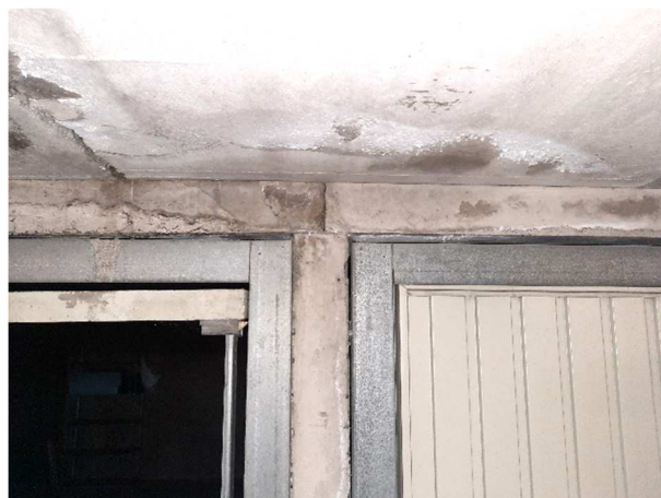
Figuur 13 – Openstaande voeg tussen balken t.p.v. drukzone (in veronderstelling van een doorlopende balk)
