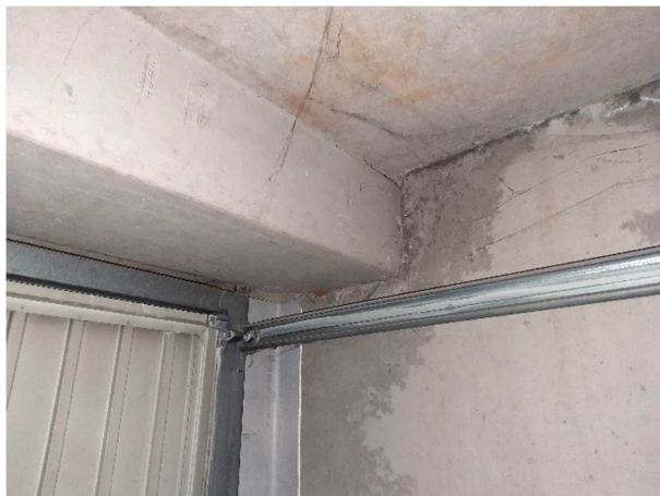
Figuur 11 – Verzakking van balk t.p.v. opleg bij BOX 40
