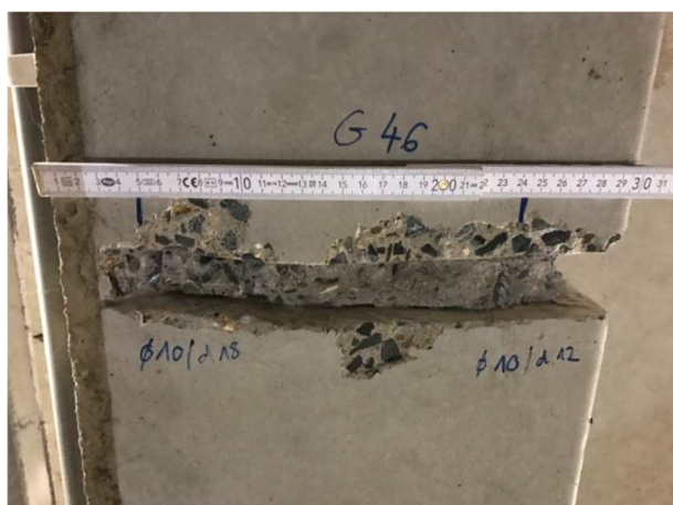
Figuur 14 – Uitgevoerd destructief onderzoek t.p.v. de onderwapening (foto uit verslag van S.C.E.S. nv)
