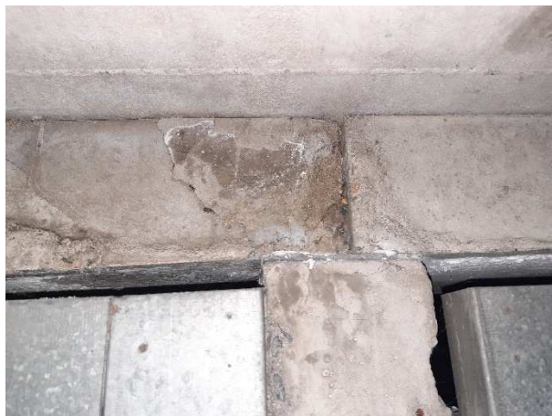
Figuur 5 – Scheurvorming in balk ter plaatse van opleg
