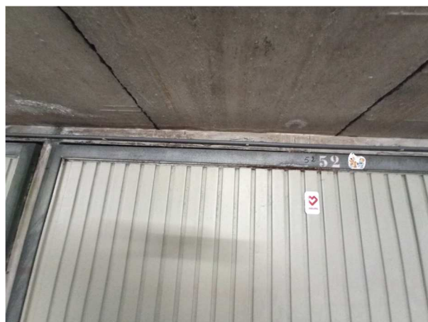
Figuur 3 – Scheurvorming van betondekking t.g.v. betonrot (foto uit verslag van S.C.E.S. nv)
