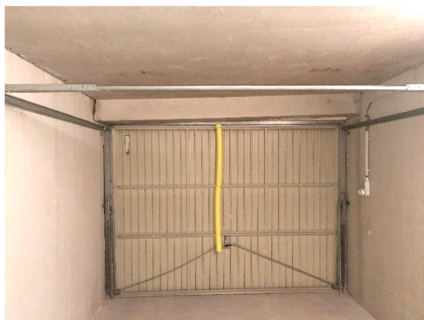
Figuur 8 – Verzakking van balk aan binnenzijde garagebox bij BOX 72
