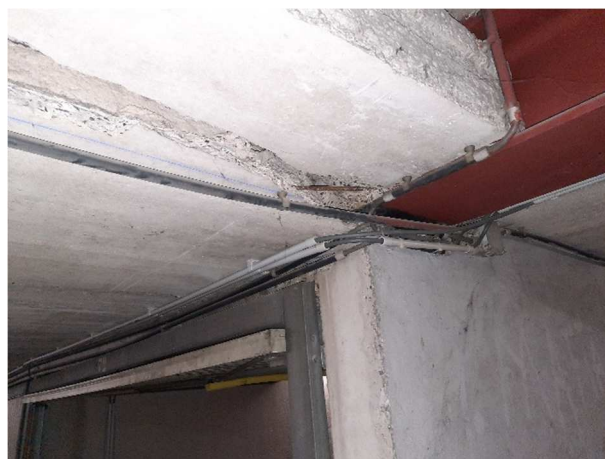
Figuur 9 – Verzakking van balk en welfsels aan buitenzijde garagebox bij BOX 72
