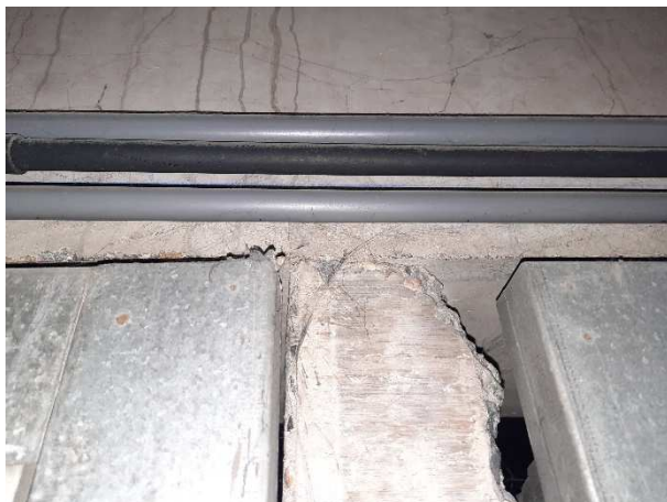
Figuur 4 – Scheurvorming in steunpunt t.p.v opleg
