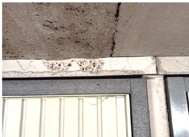
Figuur 6 – Afschilferen t.p.v. van dagvlak betonbalk (foto uit verslag van S.C.E.S. nv)
