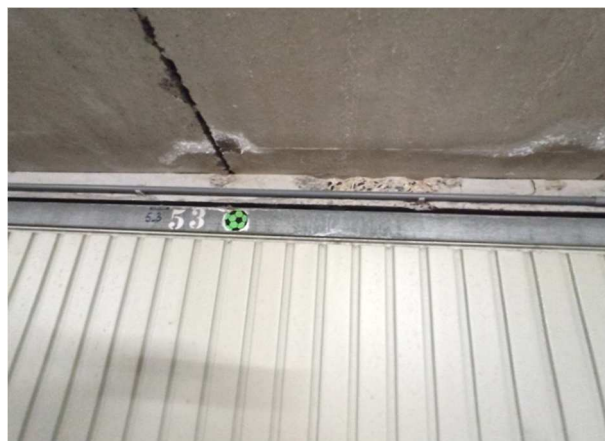
Figuur 7 – Afschilferen t.p.v. van dagvlak betonbalk (foto uit verslag van S.C.E.S. nv)
