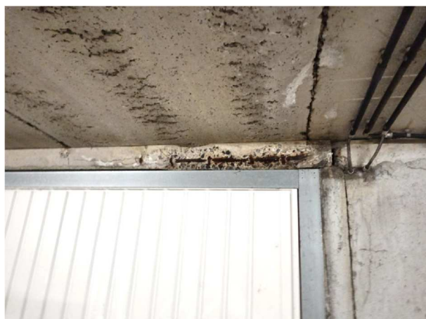
Figuur 2 – Afschilfering van betondekking t.g.v. betonrot (foto uit verslag van S.C.E.S. nv)
