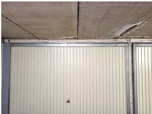
Figuur 10 – Doorbuiging van balk boven poort bij BOX 40 (foto uit verslag van S.C.E.S. nv)
