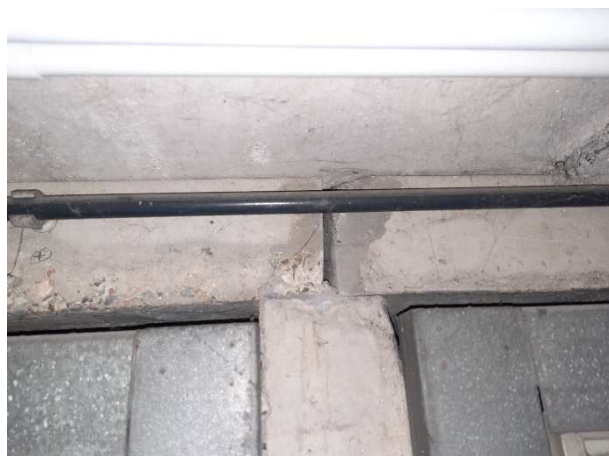
Figuur 12 – Openstaande voeg tussen balken t.p.v. drukzone (in veronderstelling van een doorlopende balk)
