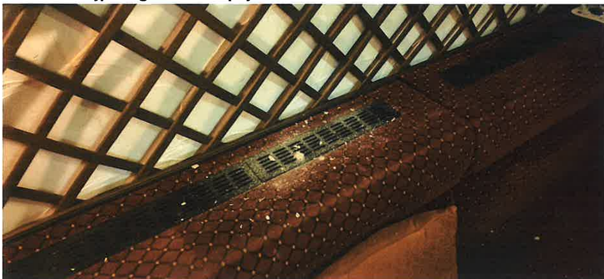
Door de insijpeling komt het pleisterwerk los
