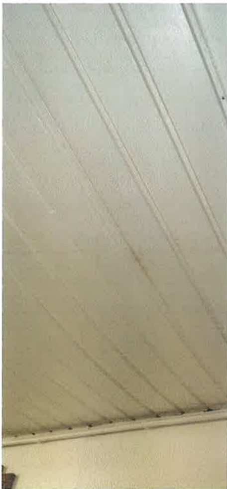
2 de scheur in plafond
