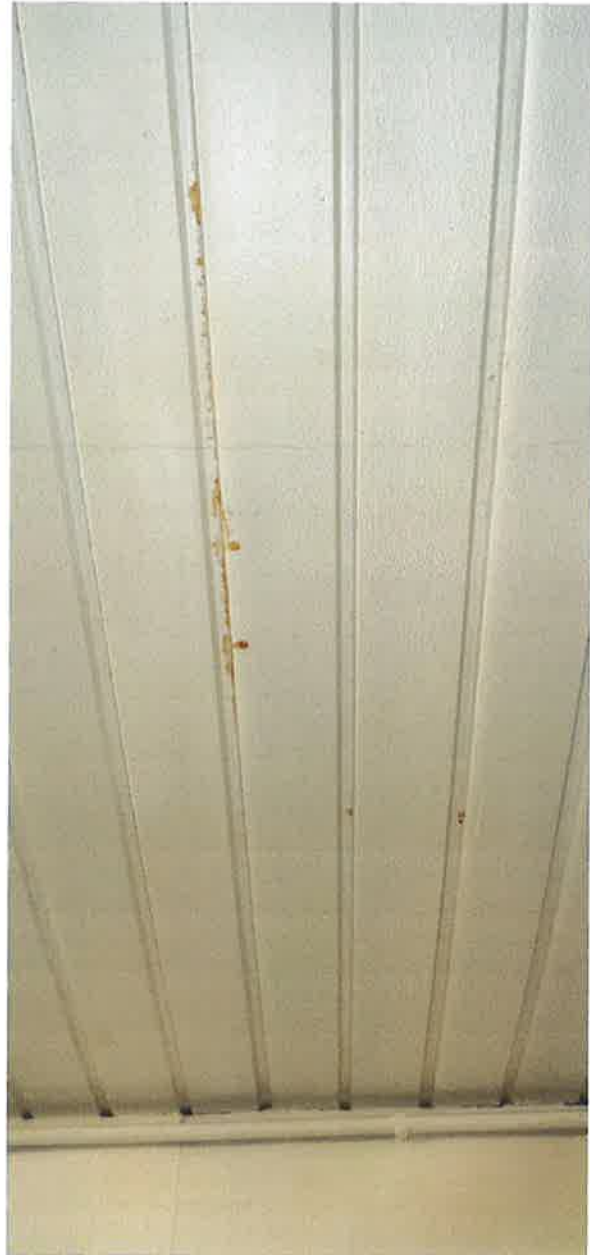
Verkleuring plafond door regen
