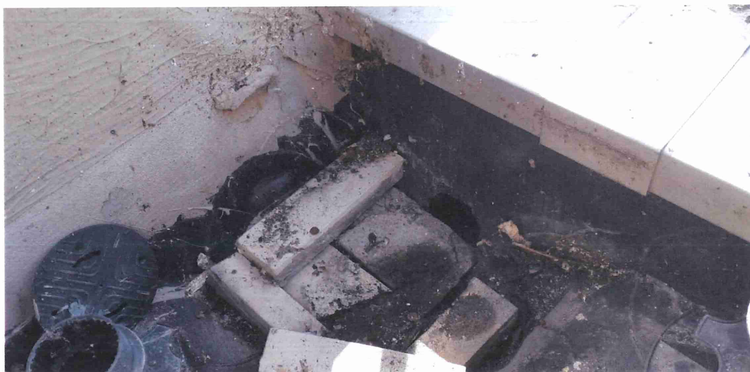
Tapgat voor de helft verhinderd door de tegelbrokken
