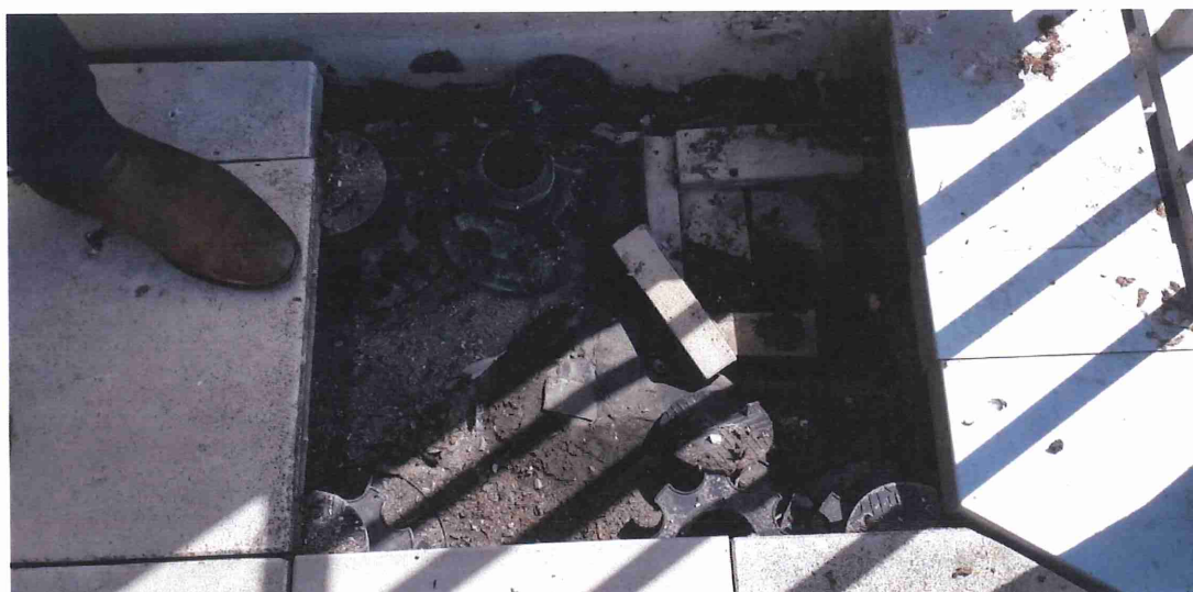
Stukken tegel gestapeld in de uitsparing voor de tapbuis beletten een vlotte afwatering
