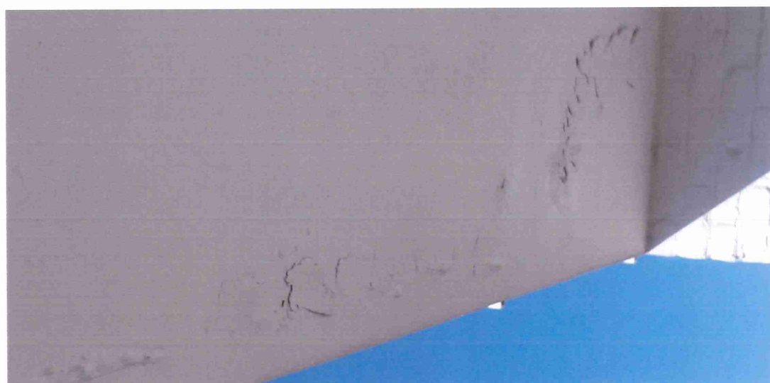
Afbladdering van de coating op de dakluifel achtergevel 9 de verdieping
