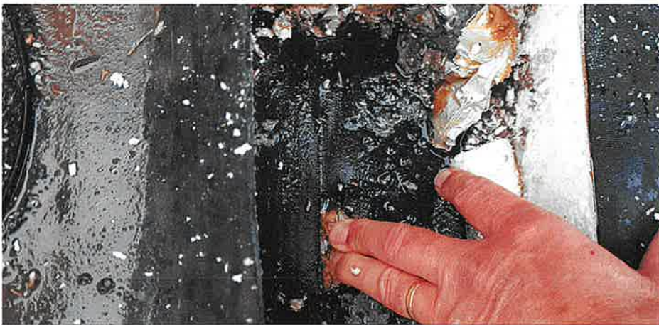
5 – Bij insnijding van de laag Resitrix onder de bovenste isolatie blijkt dat er ook onder deze laag thermische isolatie aanwezig is.
