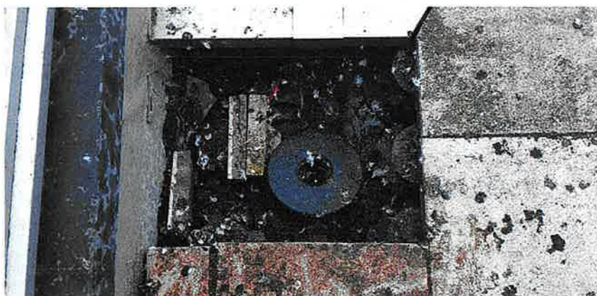
Aangetroffen toestand van vervuiling van het achterterrasdak van de 10 de verdieping
