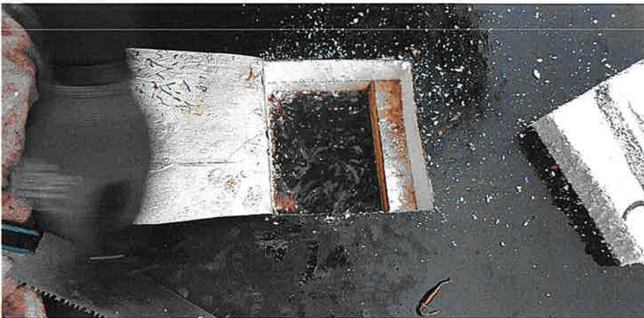
3 – Tweede sondering, linkerkzijde dak : veel water aanwezig tussen isolatie en onderliggende dakdichting in Resitrix; isolatiedikte 11 cm
