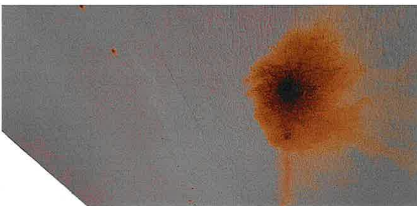
Roestuitbloeiing onderkant luifel boven verdieping 9
