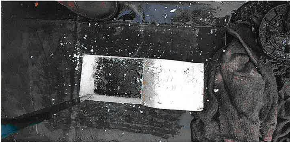
4 – Derde sondering, rechterkant dak : veel water aanwezig tussen isolatie en onderliggende dakdichting in Resitrix; isolatiedikte 8 cm
